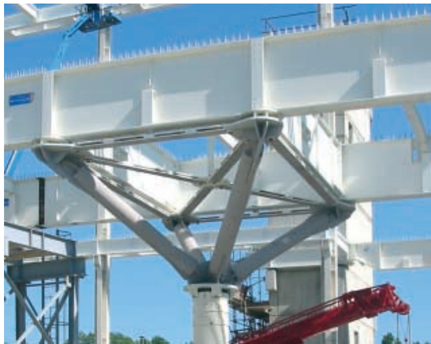
Fig. 13 - Una delle colonne portanti a sezione mista acciaio-cemento armato, in fase di costruzione
