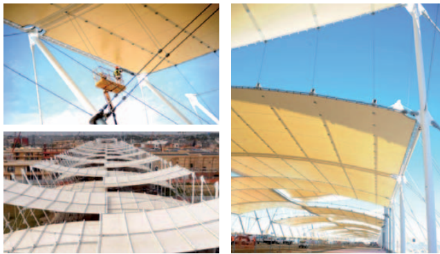
Figura 8: a) Operazioni di verniciatura della struttura in acciaio in opera, b) e c) vista aerea e da dentro i camminamenti delle strutture metalliche e della membrana di copertura del Decumano
